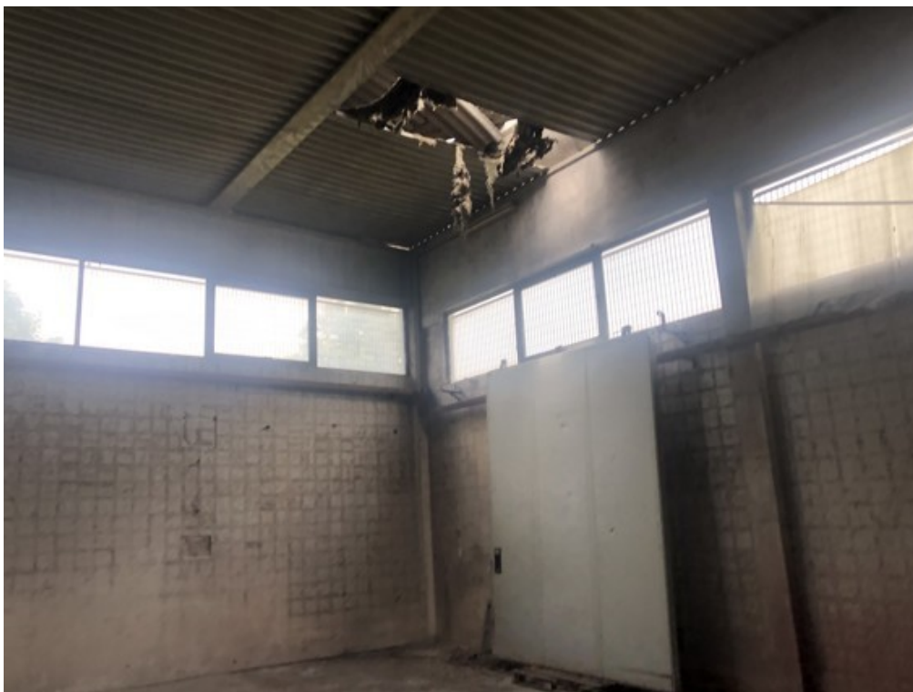
Fotografia A.29 - Corpo A - Capannone particolare danni copertura
