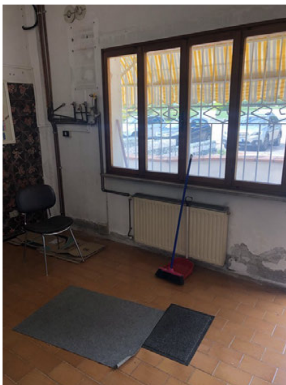
Fotografia A.45 - Corpo B - Particolare collegamenti caldaia murale rimossa - pranzo
