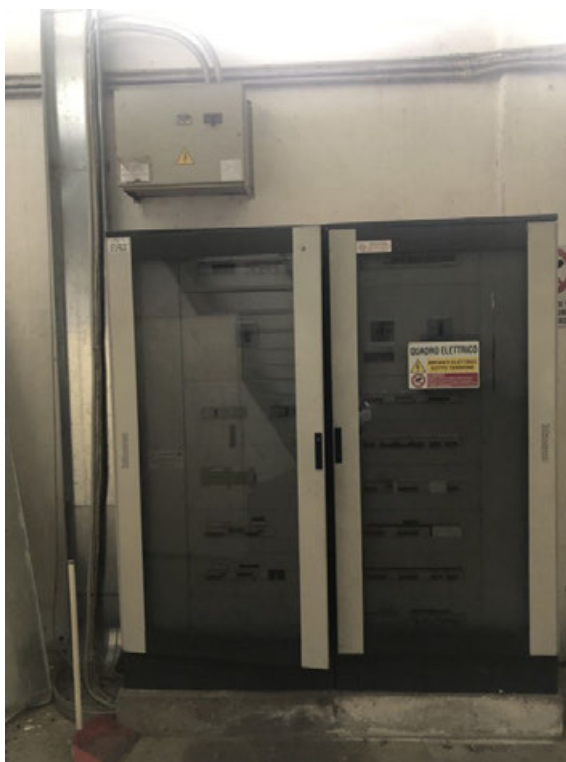
Fotografia A.35 - Corpo A - Capannone - particolare quadro elettrico
