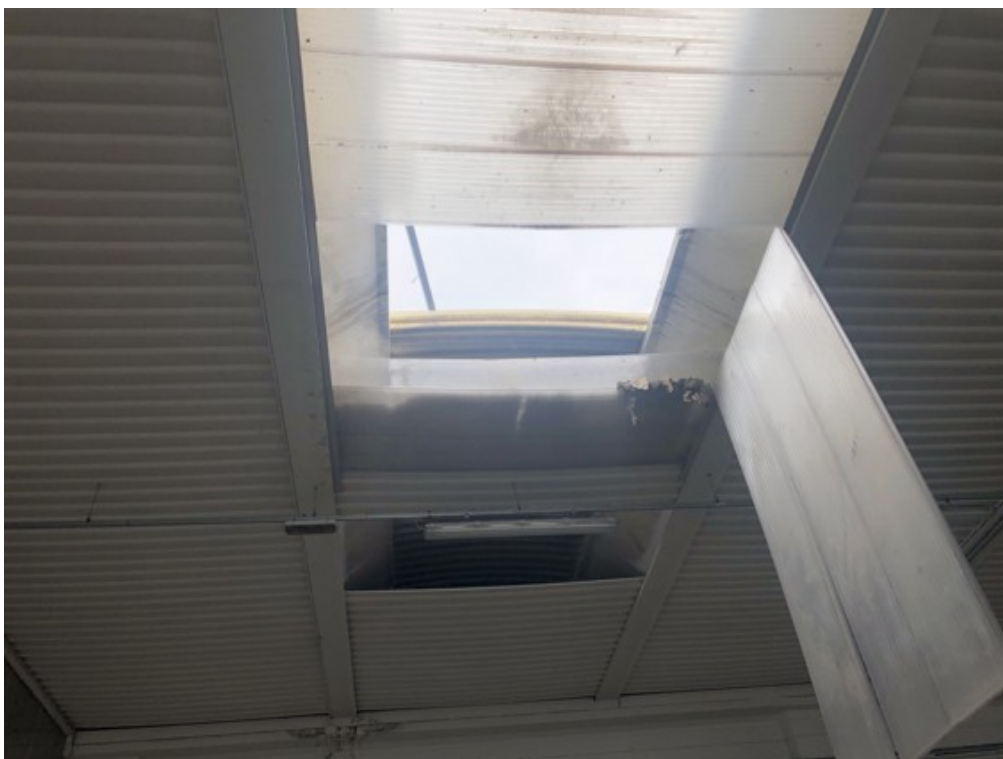
Fotografia A.30 - Corpo A - Capannone particolare danni copertura
