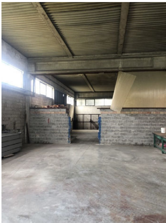
Fotografia A.27 - Corpo A - Capannone angolo sud-est - muratura con varco
