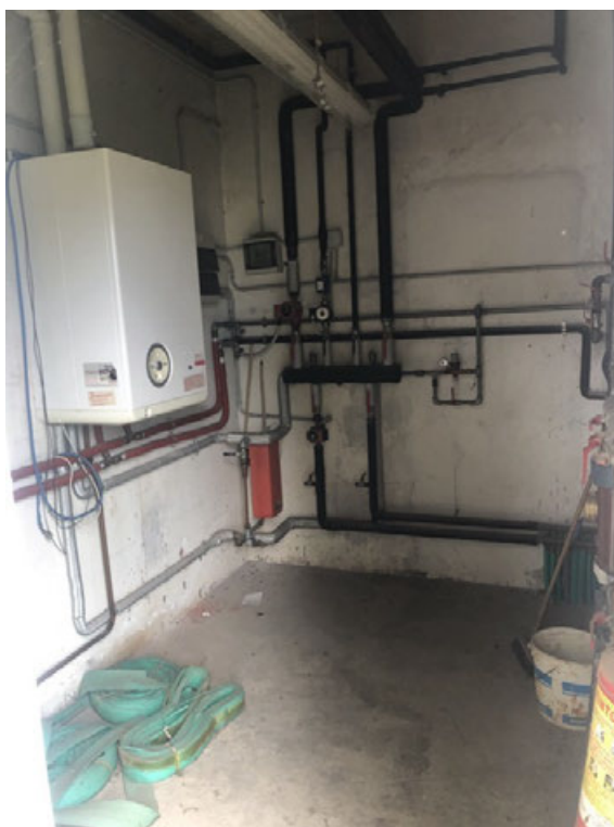
Fotografia A.39 - Corpo A - Capannone - particolare centarle termica accesso esterno lato ovest
