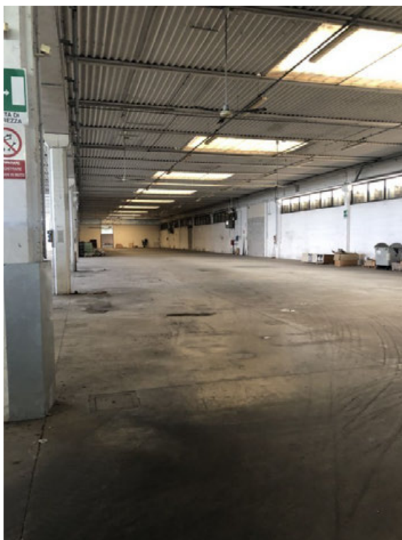
Fotografia A.28 - Corpo A - Capannone lato a sud - aderenza con altra proprietà
